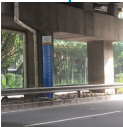
下穿隧道的水尺
