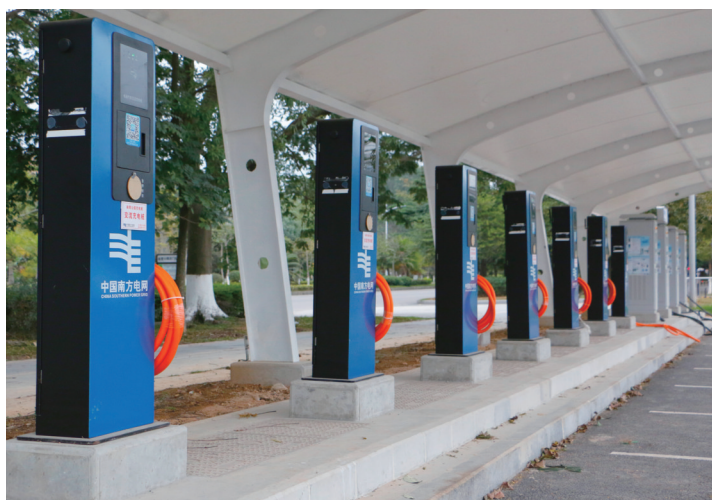
东莞供电局共建成235个电动汽车充电桩
